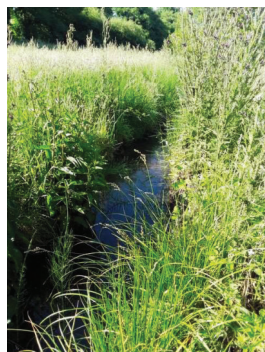
5- Vue en amont de la buse cassée – faciès lent et colmatage limoneux
