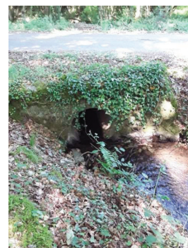
16- Buse mal calée (S13)
