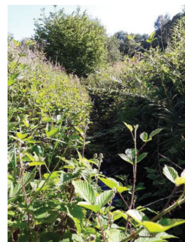
6- Vue en aval de la buse cassée – profil étroit aux berges hautes
